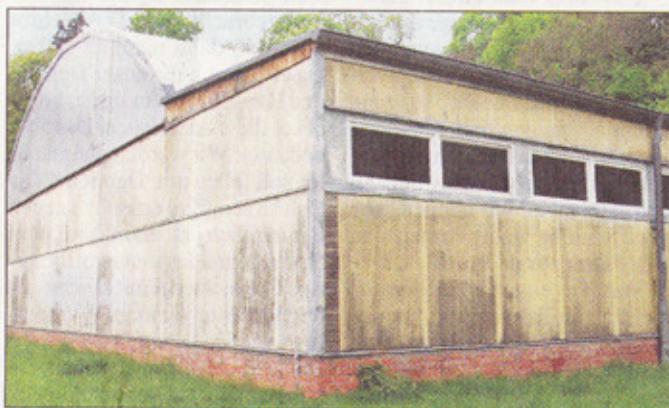
Dringender Sanierungsbedarf: Die KT 60 genannte Sporthalle im Freienwalder Schlosspark.
